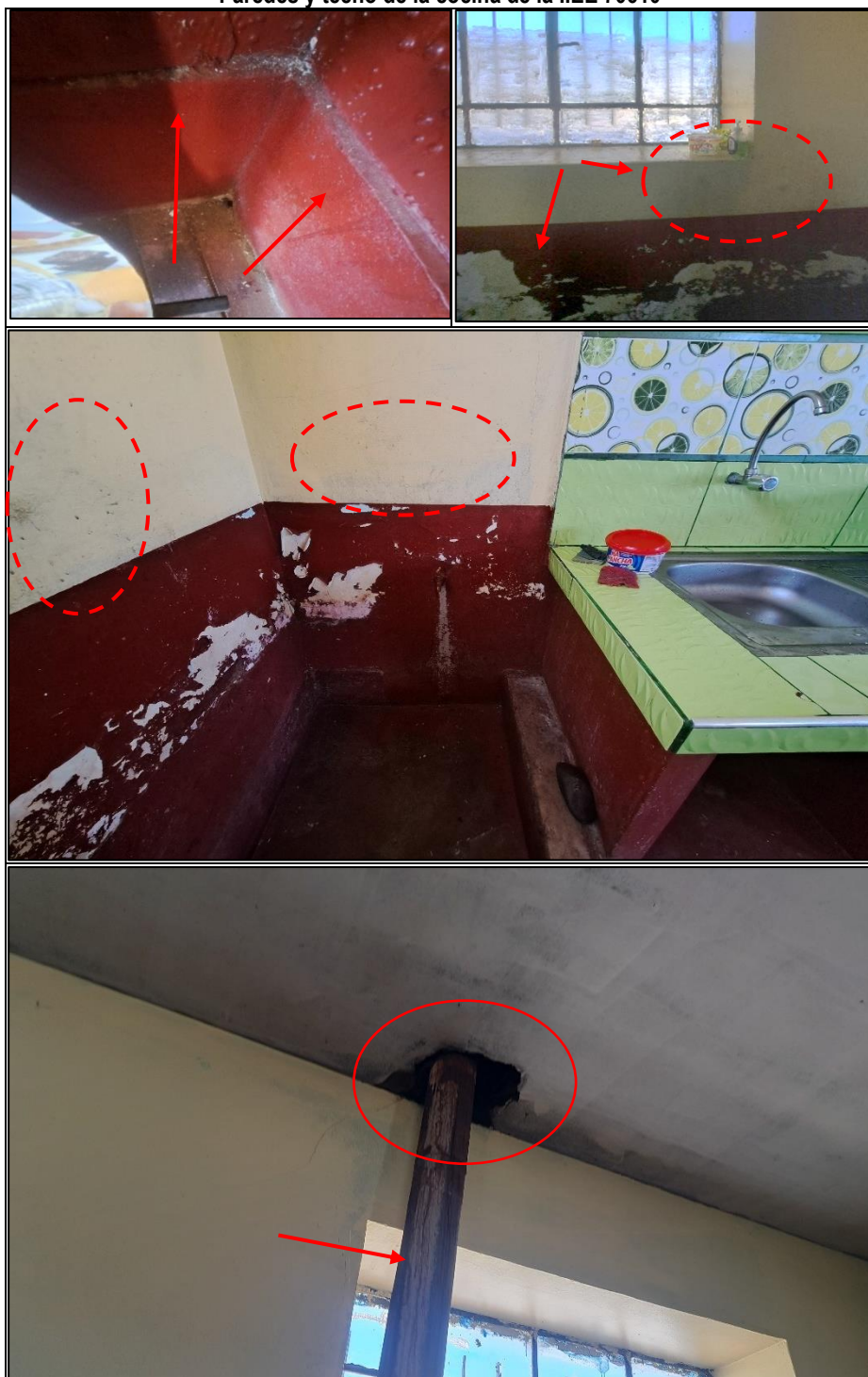
Imagen n.º 14 Paredes y techo de la cocina de la IIEE 70610
