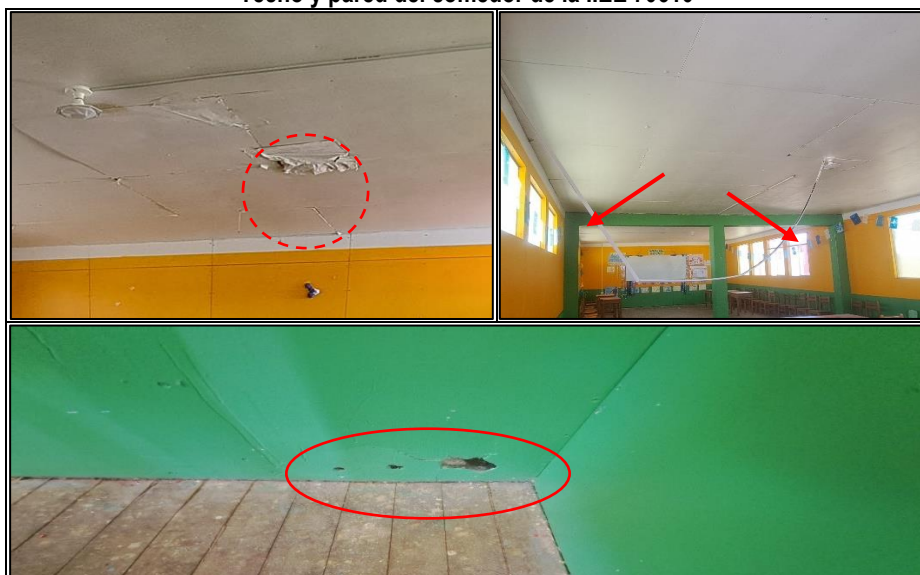
Imagen n.º 17 Techo y pared del comedor de la IIEE 70610
