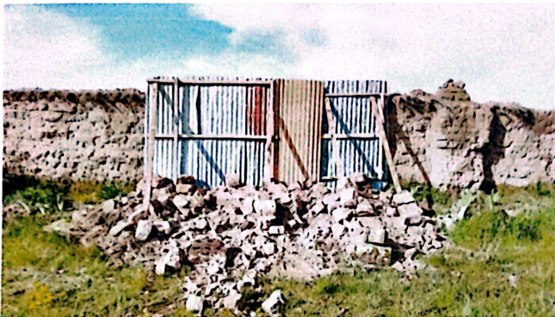
CUBRIENDO EL MURO COLAPSADO CON CALAMINAS USADAS.
