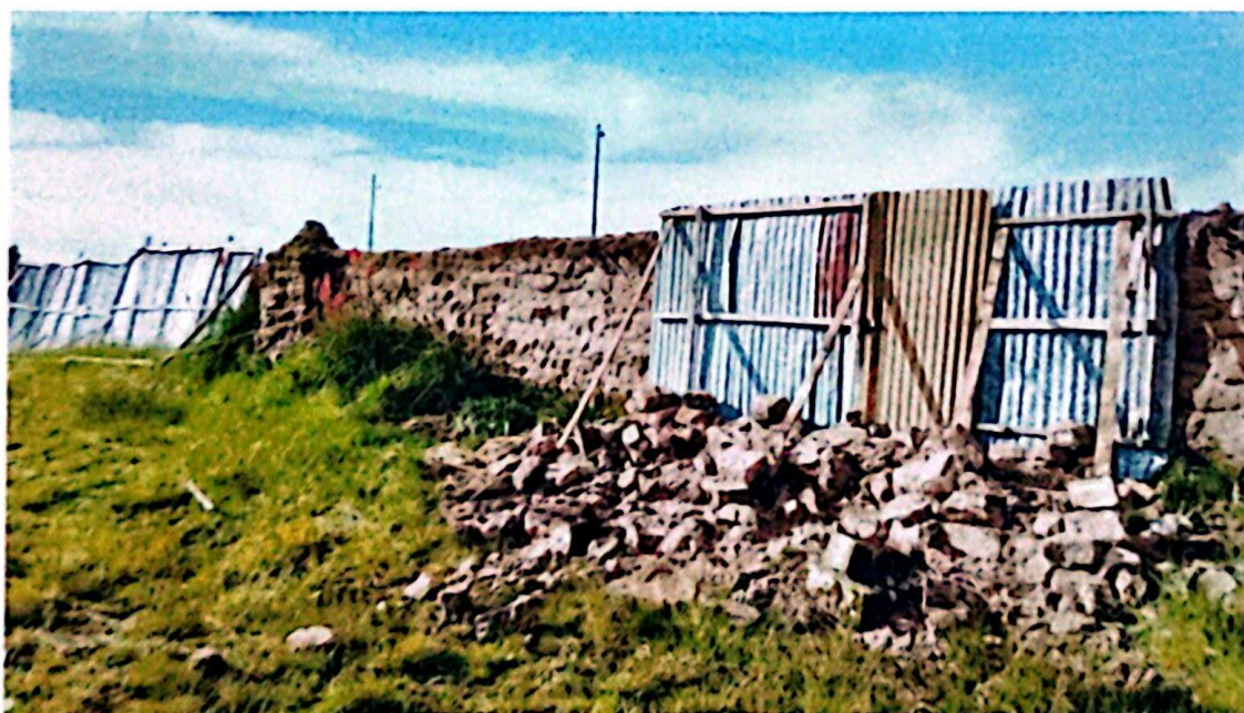
CUBRIENDO EL MURO COLAPSADO CON CALAMINAS USADAS.
