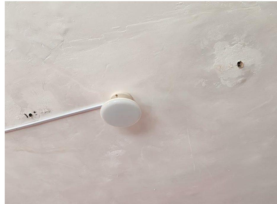
Se evidencia el deterioro del cielo raso, por la filtración de agua de la cobertura
