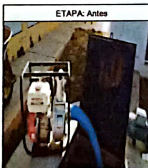
se necesita limpiar el pozo porque en la base tiene tierra.
