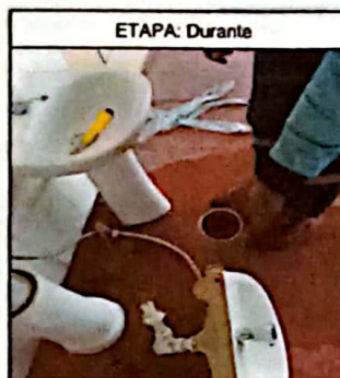
Limpeza y cambio de mangueras de lavamanos de los niños
