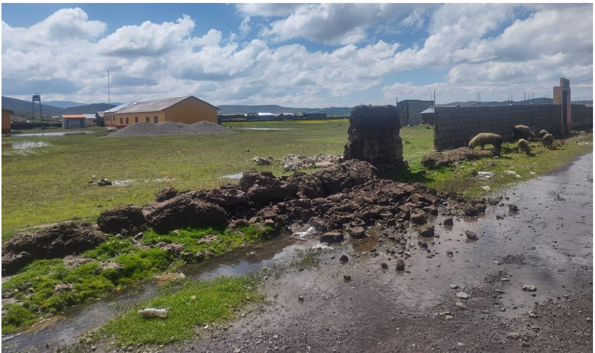
FOTO N°04: MURO CAIDO DE BARRO
