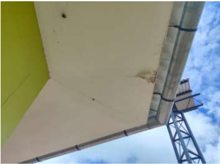
TUMBADILLO DE BAÑOS ESTA DESPRENDIENDOSE
