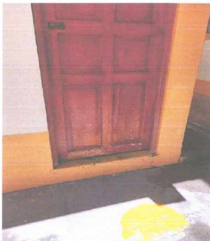
Puerta de madera deteriorado de Subdirección
