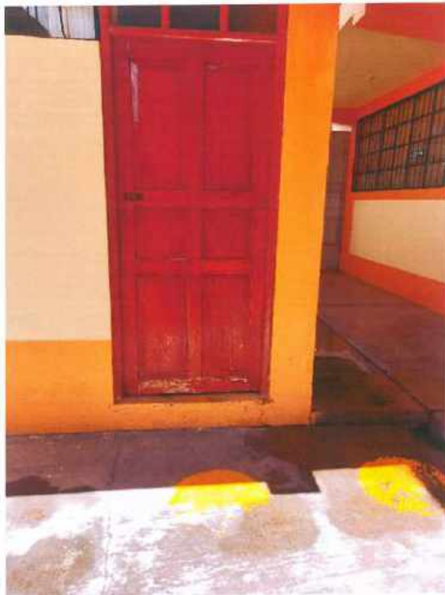
Puerta deteriorada de subdirección
