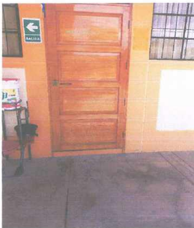
Puerta de madera deteriorado del aula inicial intermedio
