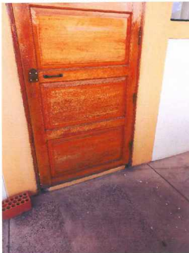
Puerta deteriorada de cuarto grado
