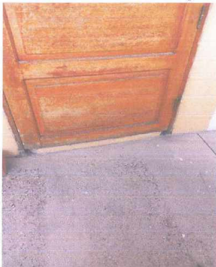
Puerta de madera deteriorado del 4° grado
