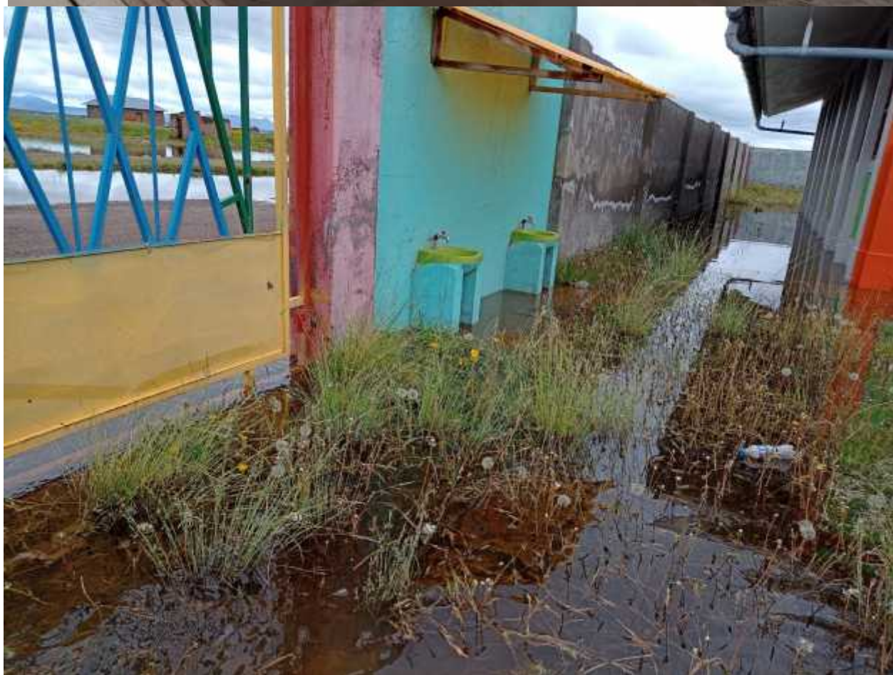
Imágenes de la institución educativa inicia 317 sarapi arroyo se encuentra totalmente inundado.
